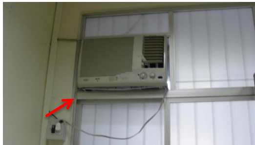
FIG. 05 - Remoção de equipamento 4 (Sinalizado com seta) – Setor de Ambulatório-Coleta de Exames
