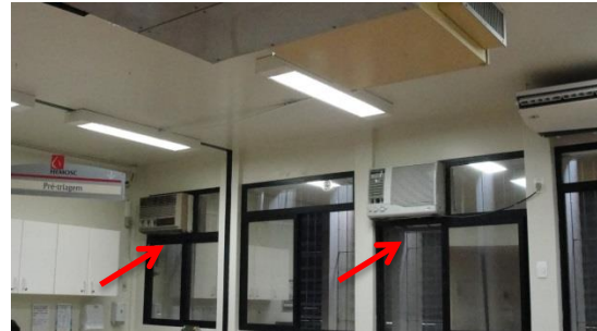
FIG.02 - Remoção de equipamentos 2 e 3 (Sinalizados com seta) – Setor de Coleta
